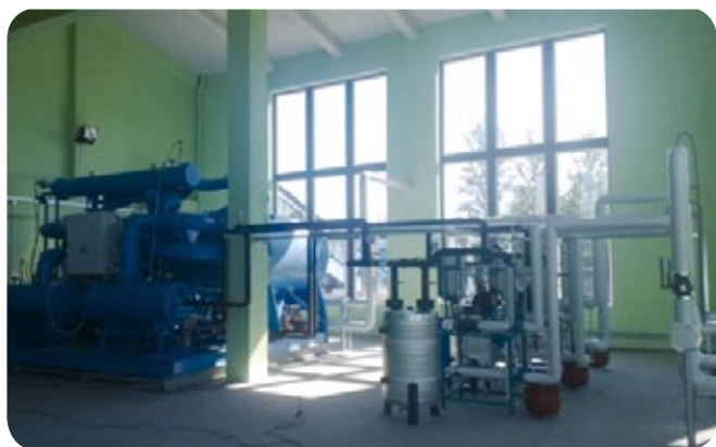
Fot.1 Instalacja testowa w elektrociepłowni Fortum w Częstochowie
